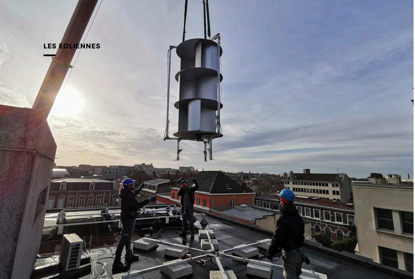
Une éolienne urbaine installée sur le toit de la médiathèque de Roubaix en décembre dernier
